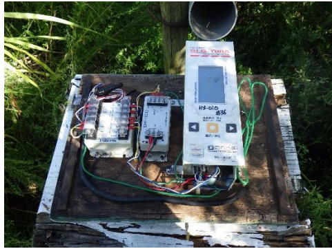
地盤伸縮計 HS-010 の架台の経年劣化
