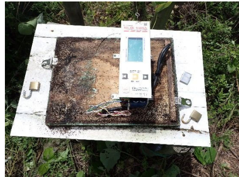
地盤伸縮計 HS-013 の架台の経年劣化
