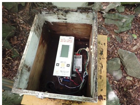
縦型伸縮計 YB-209-1 の架台の経年劣化
