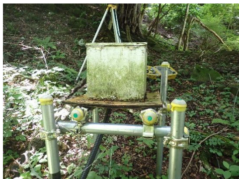
縦型伸縮計 YB-212-1 の架台の経年劣化
