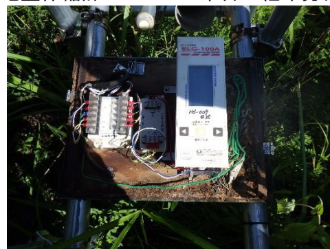
地盤伸縮計 HS-009 の架台の経年劣化
