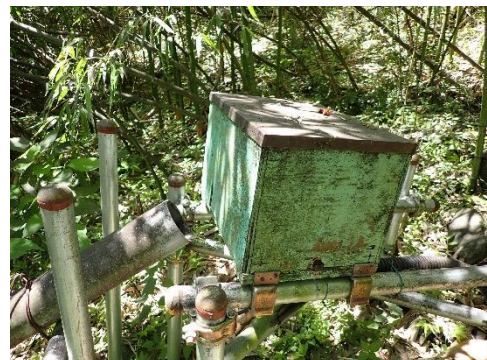
地盤伸縮計 HS-002 の架台の経年劣化
