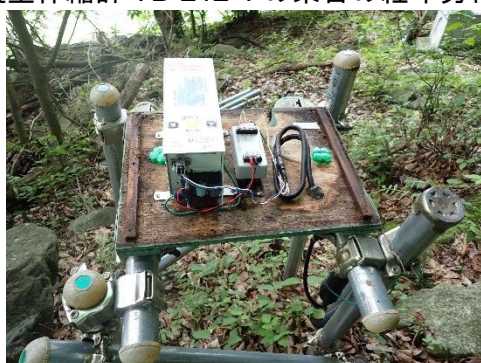
縦型伸縮計 YB-232-1 の架台の経年劣化
