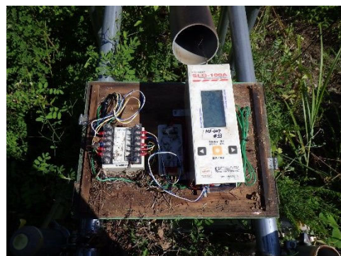
地盤伸縮計 HS-007 の架台の経年劣化
