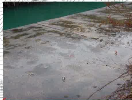
NA-T3 既設のアイボルトが健全であることを確認した。作業時はアイボルトと安全帯を使用することを周知徹底する。
