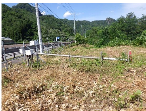
地盤伸縮計 HS-004 の架台の経年劣化
