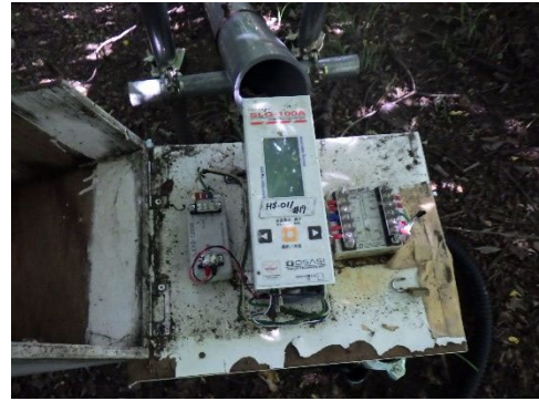
地盤伸縮計 HS-011 の架台の経年劣化
