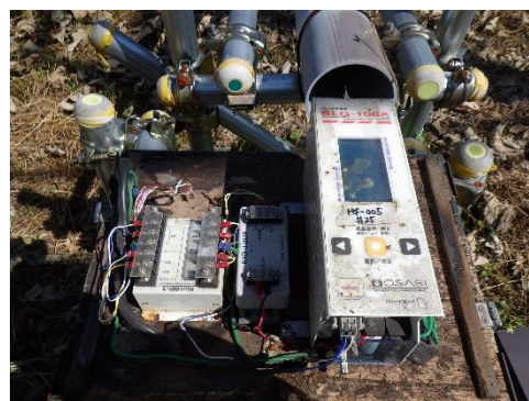
地盤伸縮計 HS-005 の収納箱の破損
