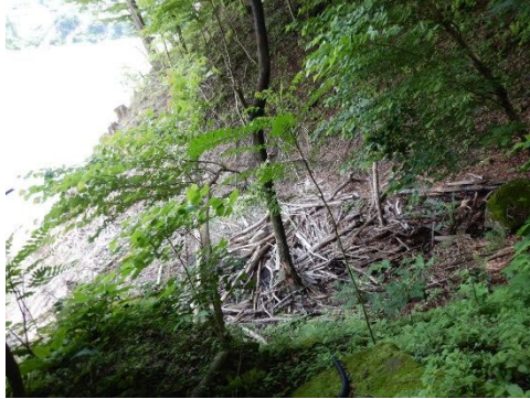
通信ケーブルの流木との絡まり
