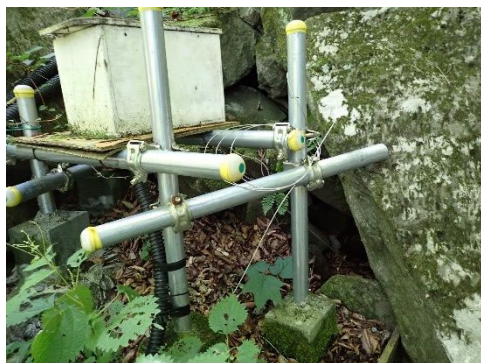
縦型伸縮計 YB-201-1 の架台の経年劣化
