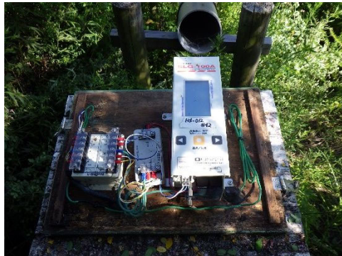
地盤伸縮計 HS-012 の架台の経年劣化
