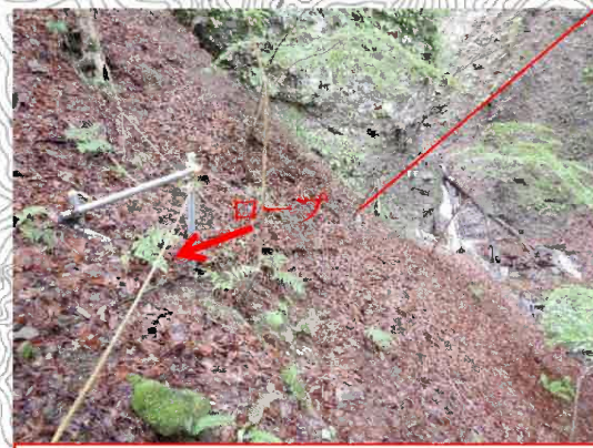
NB-212-1 既設のロープは健全であることを確認した。作業時はロープを使用することを周知徹底する。
