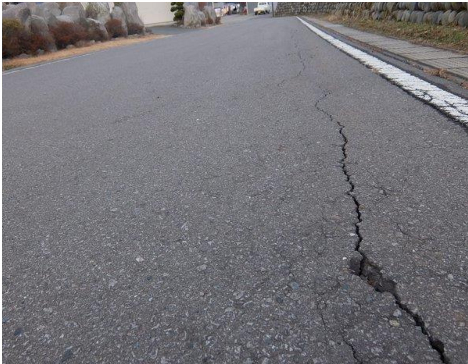
川原湯地区打越代替地の町道のひび割れ(2015年12月25日撮影) 鉄鋼スラグによるものでは？
