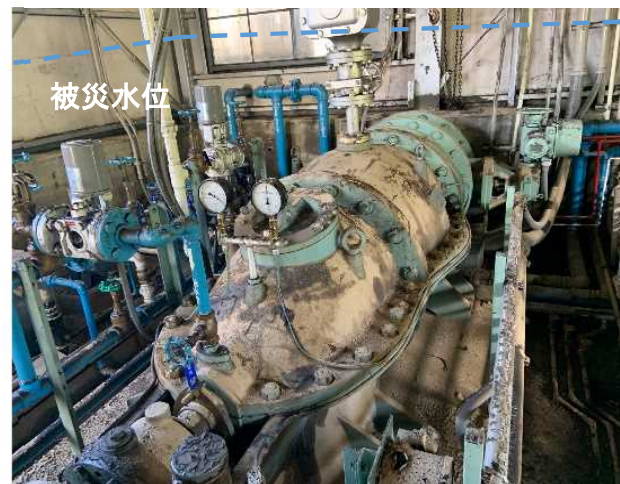
雨水ポンプ場の被災イメージ
