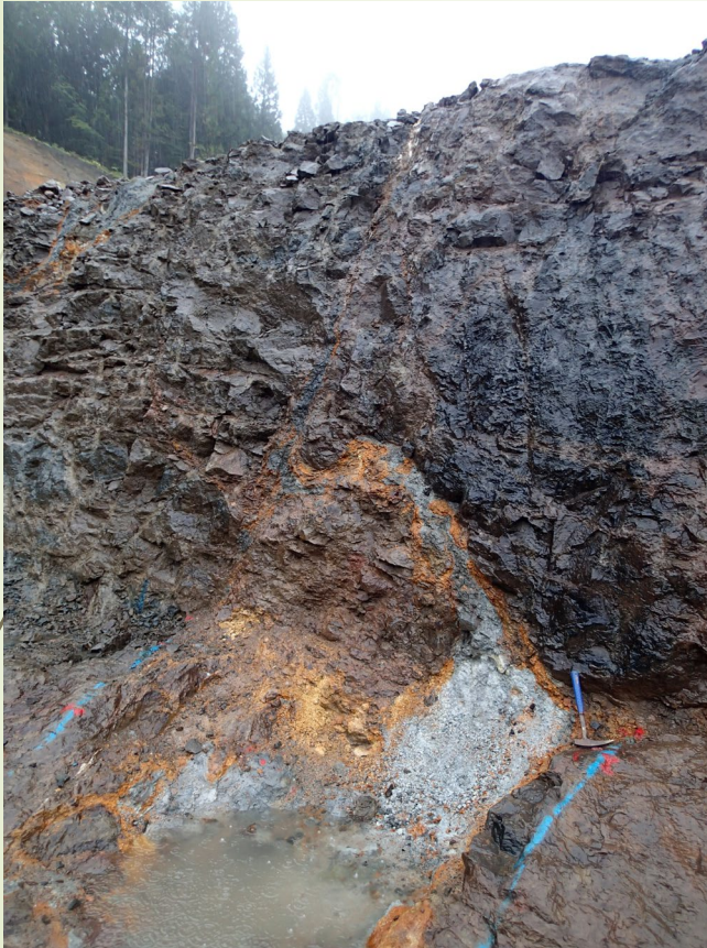
ダムサイト左岸 中央部に灰色～褐色の変質部
